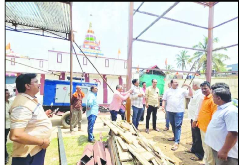
ಧಾರವಾಡದ ಗುಲಗಂಜಿ ಕೊಪ್ಪದಲ್ಲಿರುವ ಶ್ರೀ ಹನುಮಂತ ದೇವರ ದೇವಸ್ಥಾನದ ಸಮೀಪ ನೂತನವಾಗಿ ನಿರ್ಮಾಣವಾಗುತ್ತಿರುವ ರಥಮನೆ ಕಾಮಗಾರಿಯನ್ನು ಮಾಜಿ ಮಹಾಪೌರರು ಹಾಗೂ ಸಭಾನಾಯಕರಾದ ಈಶೇಶ ಅಂಚಟಗೇರಿ ಪರಿಶೀಲಿಸಿದರು. ಗಂಗಾಸಾಹೇಬ ದೇಸಾಯಿ, ನಾಗೇಶ ಕುಸುಗಲ, ಪುಟ್ಟು ಚವ್ವಾನ, ಶಿವಾನಂದ ಗಿರಿಯಪ್ಪನವರ ಉಪಸ್ಥಿತರಿದ್ದರು.
